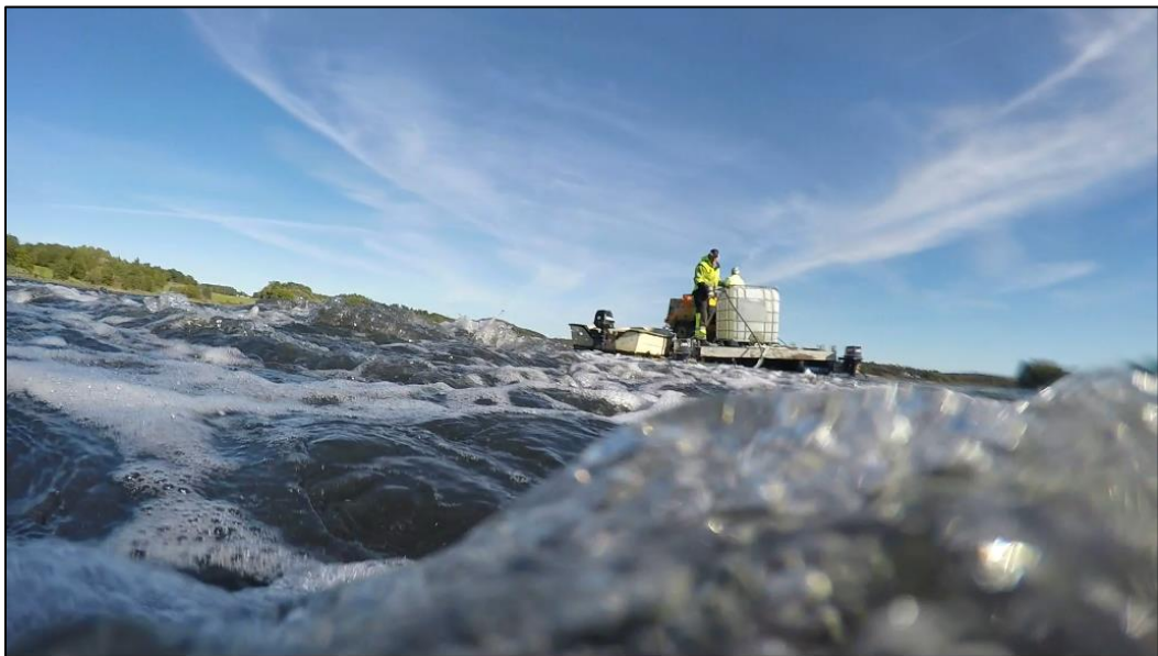
Figur 9 Luftinjisering observert fra vannet.
